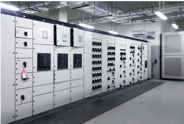
Équipements industriels basse tension
