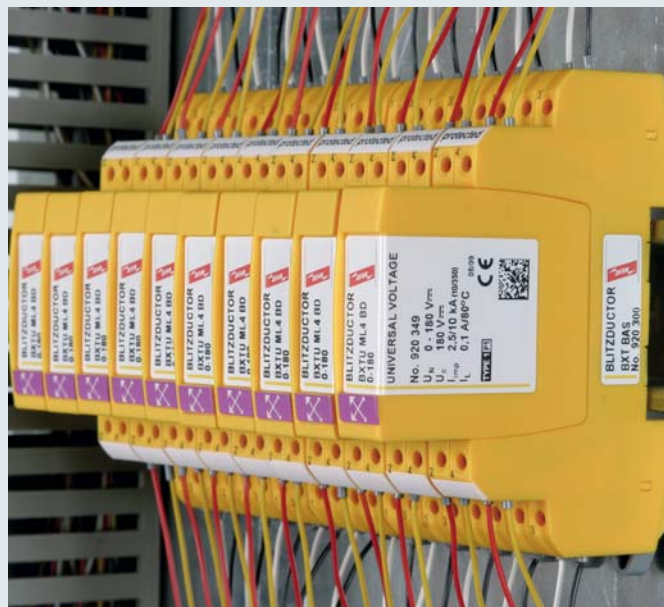
BLITZDUCTOR XTU intégré à l'installation.
